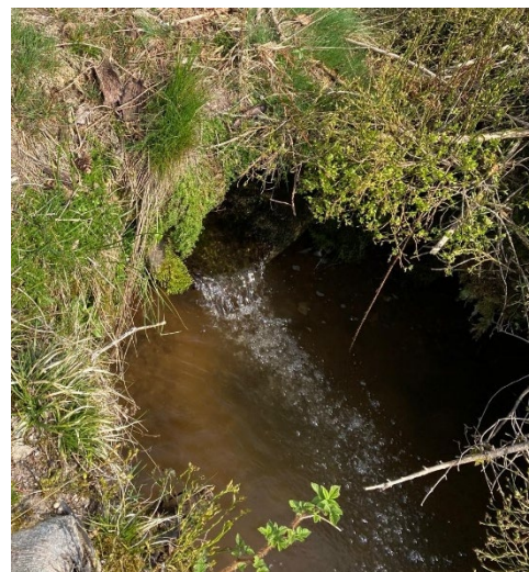
Une buse sur le lit du ruisseau principal de la Vigotte avec création d'une chute et rupture écologique
