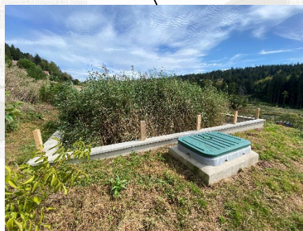
Nouvelle phytoépuration collective
